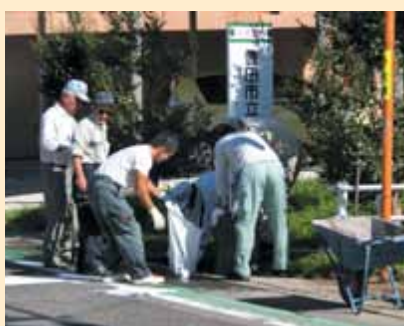
排水溝溜柵のド口除去
